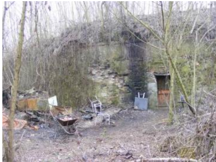
Stato di abbandono e degrado di uno dei bonetti
