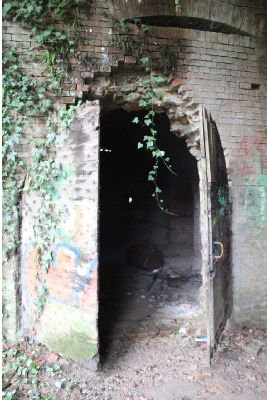
Struttura attuale con elementi che necessitano ripristino per permettere la chiusura e la messa in sicurezza
