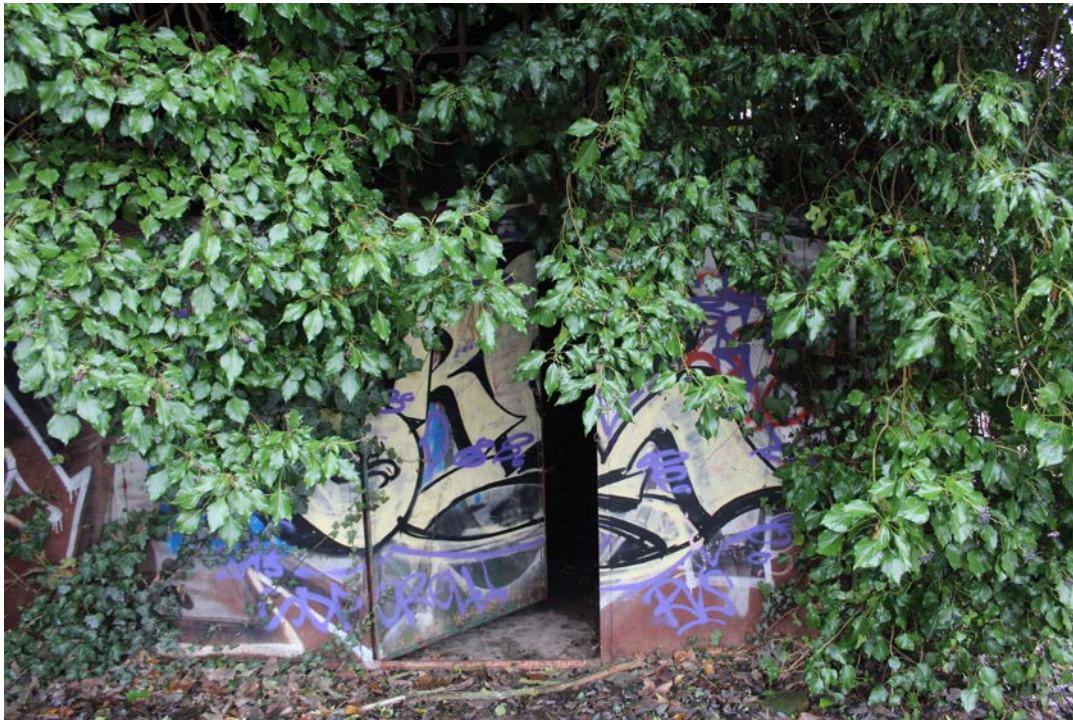
Struttura in ingresso a cui vietare l'avvicinamento per motivi di sicurezza
